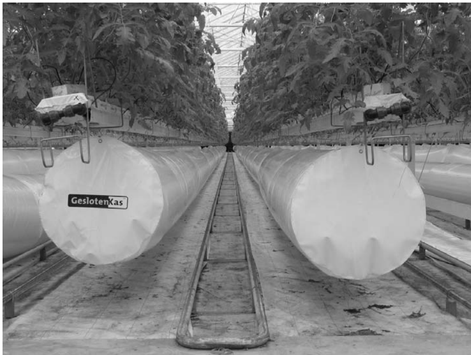
Een inblik in een GeslotenKas® waarin tomatenplanten groeien in een goot op substraat. Daaronder lopen de luchtslangen die dienen om het kasklimaat te conditioneren. In de wanden van de slangen zitten gaten waardoor koude of warme lucht de kas wordt ingeblazen. Aan het begin van de slang (in de achtergrond op de foto) staan kasten met ventilatoren die de lucht in de slang blazen.
